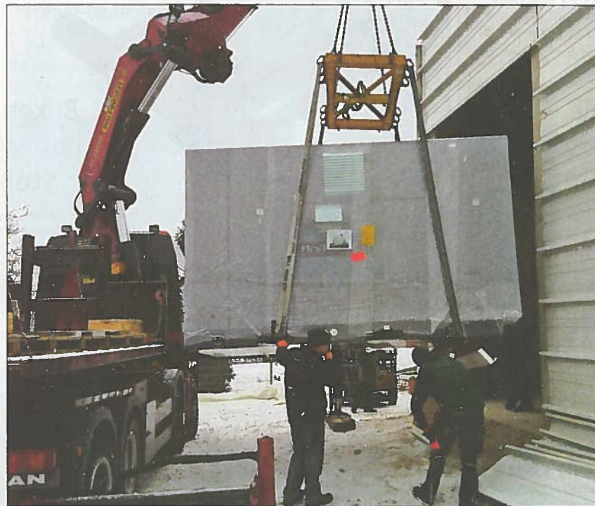
Anlieferung der Gasturbine, das Herzstück des Kombi-Power-Systems
