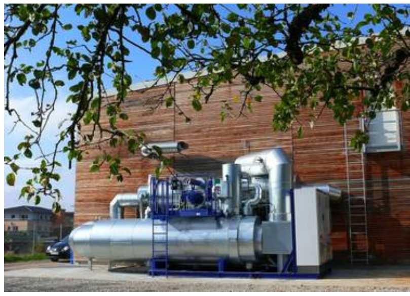
Die Naturenergie im Hersbrucker Osten mit dem großen Hackschnitzelheizwerk möchte über ein Fernwärmenetz in Richtung Stadt expandieren. Foto: J. Ruppert
